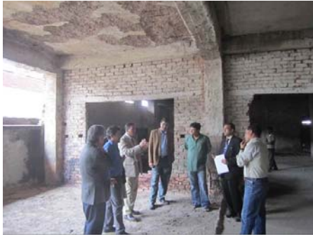
写真-3 KTS 縫製工場・火災現地調査 (火災発生階)
