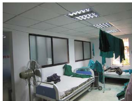
写真-2 USTC 病院・火災現地調査 （建物内部で延焼経路となった開口部）
