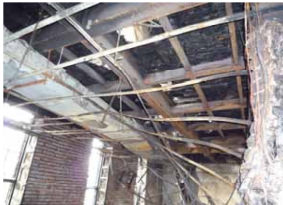
南面上部2階席の床を見上げる（木床が炭化）
