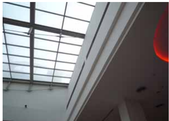
吹抜頂部で排煙義務 ( 機械排煙口スリット ) 機械排煙が一般的な計画のようである。 機械排煙では効かないはず。自然排煙の方が適切。大きなトップライトがあるのに。
