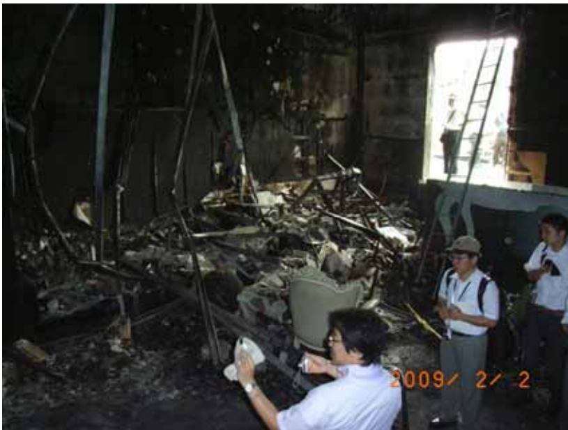
図11 VIPルームの南側テラスに面した窓(写真右側部分)。ガラスが破壊されている。
