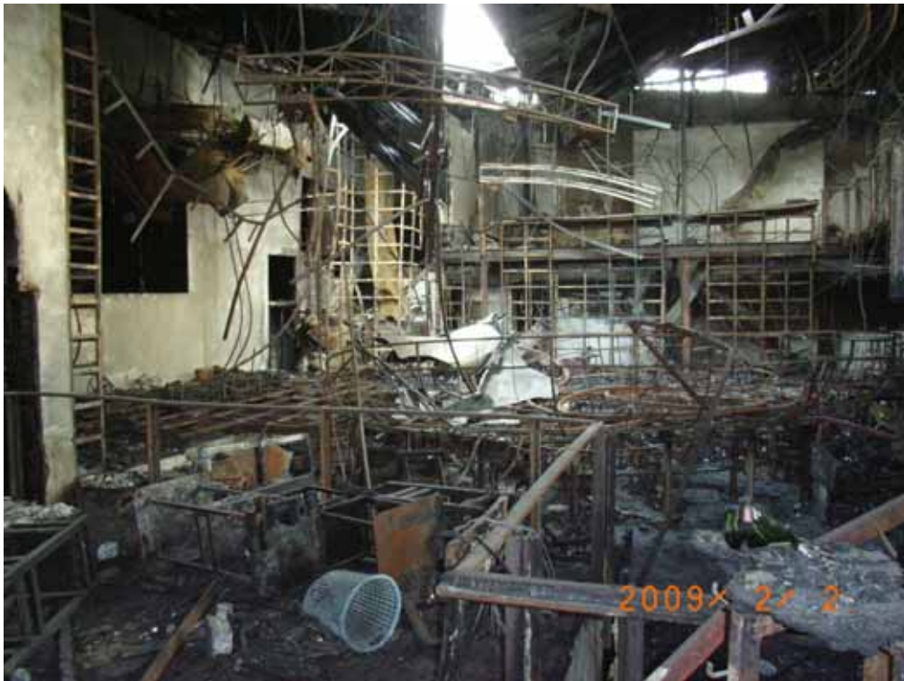
図8 エントランスホール（手前）と客席フロア（手すりの向こう側）。落下したシャンデリアの手前に半円形のスタンドがある。
