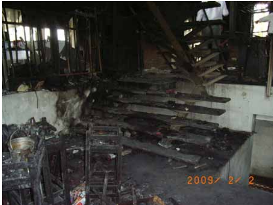
図9 客席フロアからエントランスホールへ上がる階段。階段の右半分は、2階へ上がる階段の下部に邪魔されて使えない。右は地下トイレへ降りる階段。
