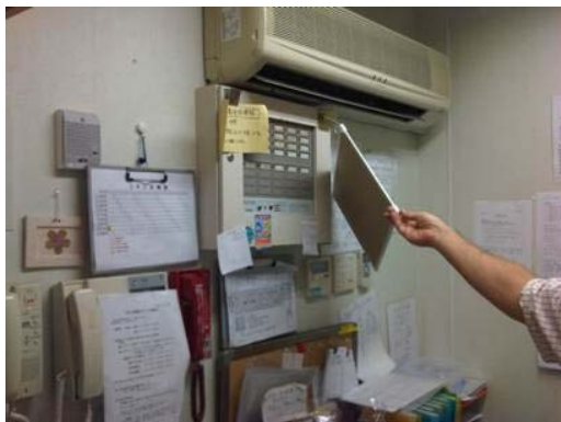
各階の副受信盤（2 階）
