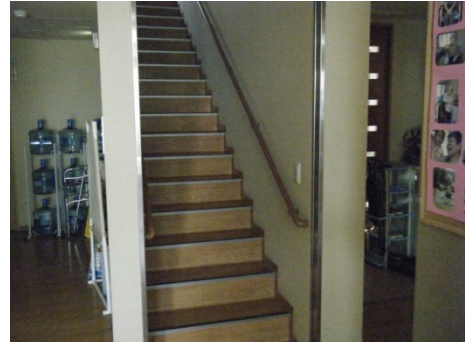
3 階への階段（入口防火シャッター）
