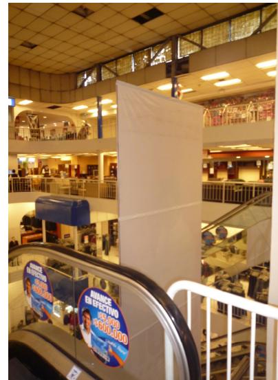
吹き抜け上部は排煙口なし
