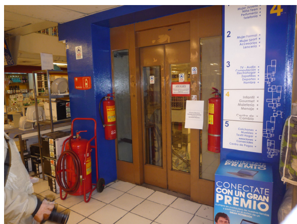
エレベータ周りに消火器が複数設置
