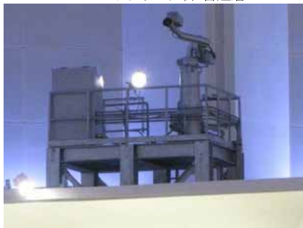
d) 放水設備
