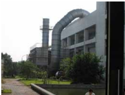
図 31 排煙処理装置
