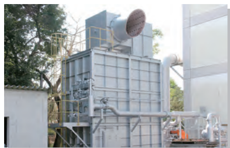
二次燃焼炉 高さ・幅：5.5メートル 奥行き：2.5メートル 最大燃焼発熱量：480万kcal/h
