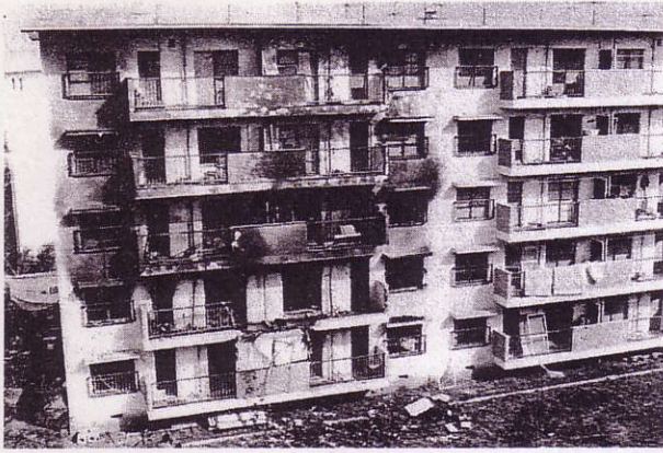
福岡県・公団日の里団地ガス爆発（延焼した外壁）
