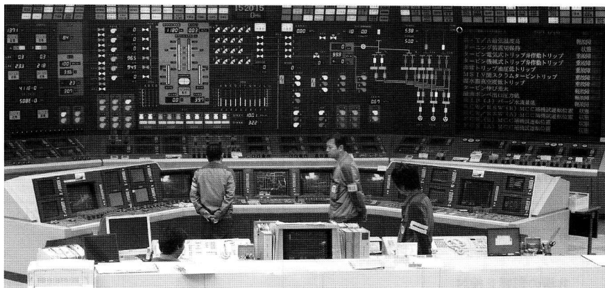
想定地震動の見直しも予想されている(写真は柏崎刈羽原発6号機の中央制御室)
