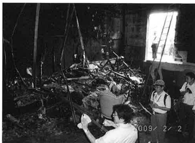
写真11 VIPルームの南側テラスに面した窓（写真右側部分）。ガラスが破壊されている。
