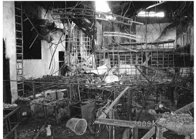
写真8 エントランスホール(手前)と客席フロア(奥)。落下したシャンデリアの手前に半円形のスタンドがある。
