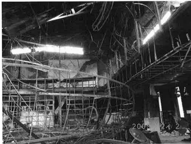
写真4 客席フロアに落下したシャンデリア (左下半分に見える円形の構造物)
