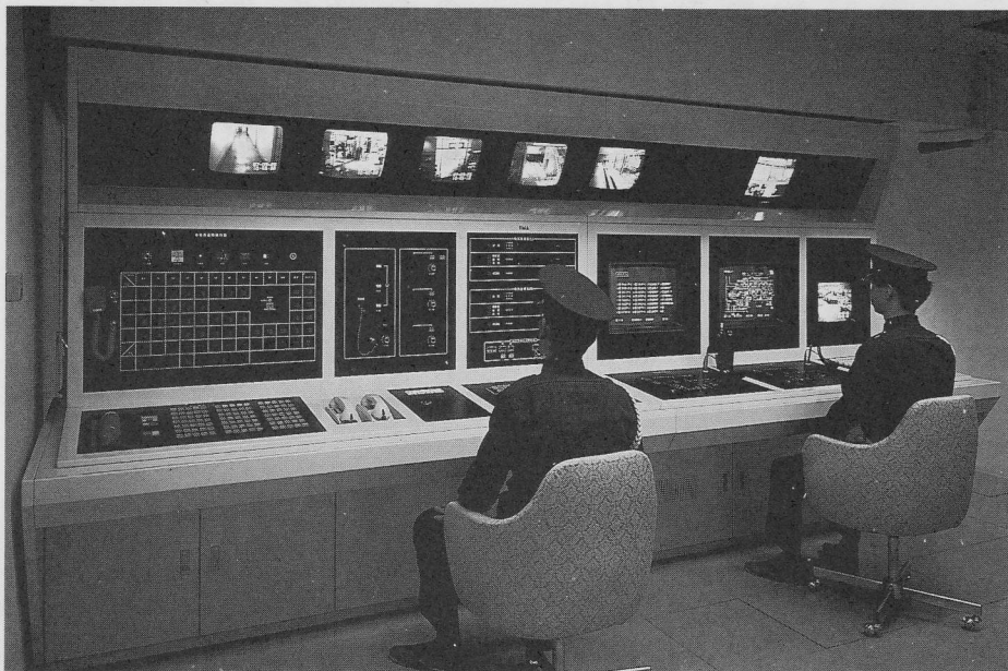
●ビルの大型化、多機能化に対応して、管理の高度化が要求され、そのような多くの現場で、写真のような機器を管理室（防災センター）に備えた総合防災管理システムが採用されている。自動火災報知設備、ガス漏れ検知設備、防排煙制御設備などと接続され、ひと目で異常事態を発見できる仕組みになっている。
