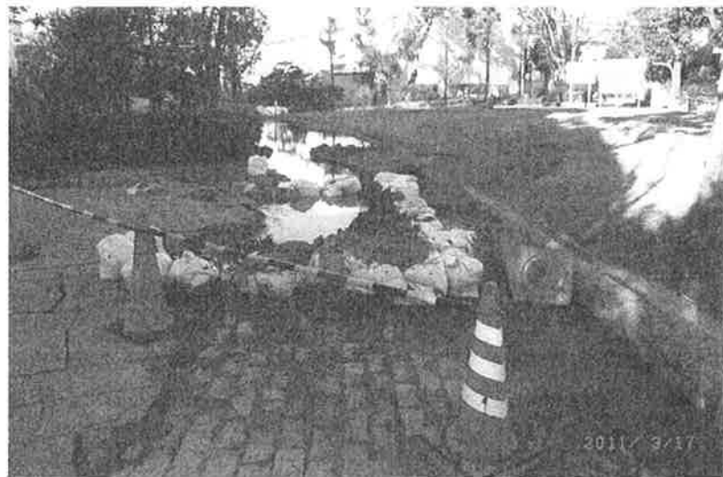
団地内道路や歩道の損壊状況
