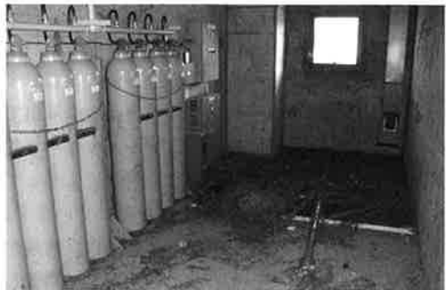
ガス貯蔵容器室の浸水跡
