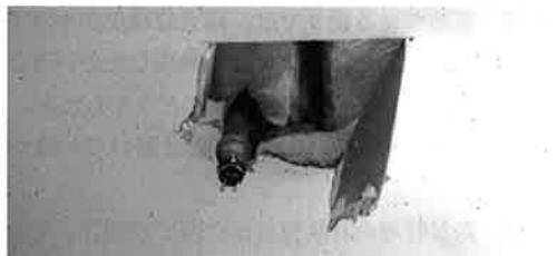
スプリンクラーヘッドの損傷例
