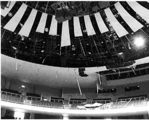
ホール被害状況
