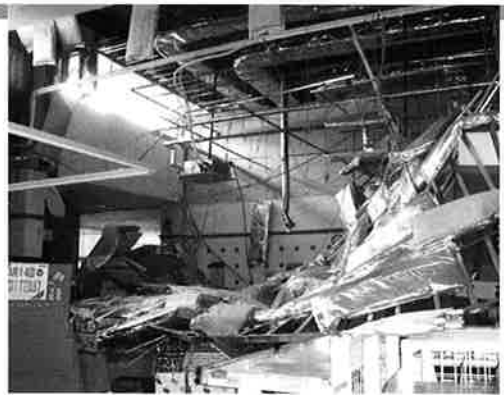
店舗内被害状況
