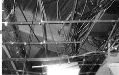
天井の脱落例
