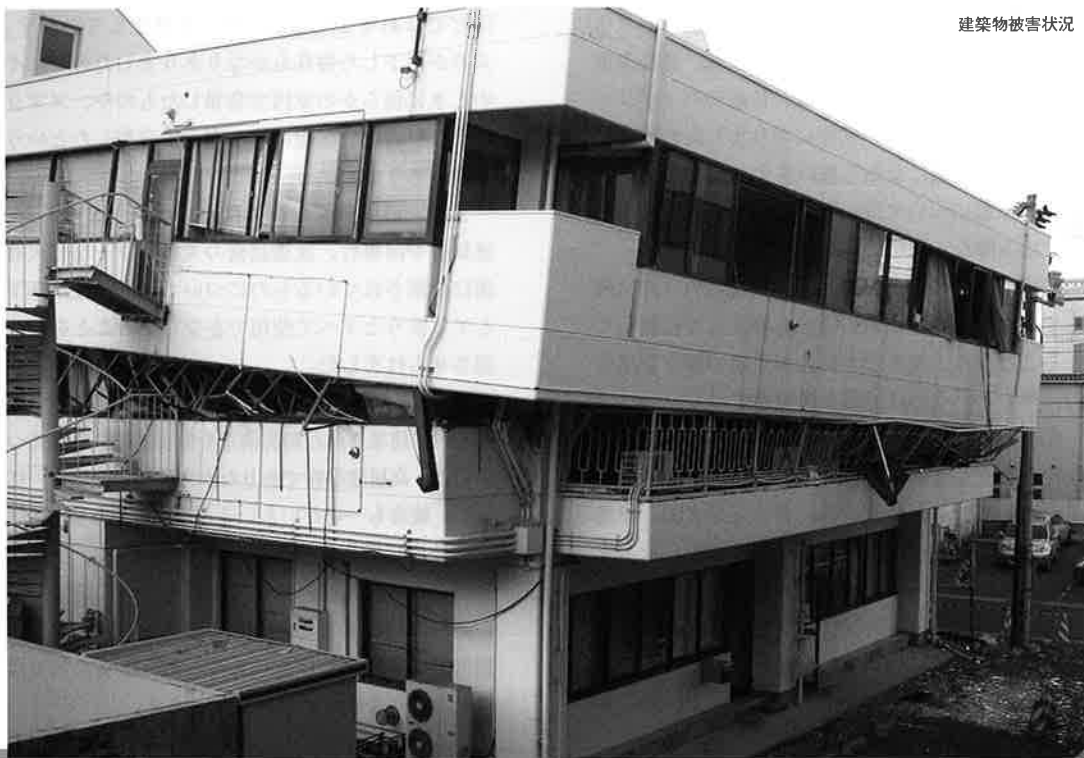
建築物被害状況
