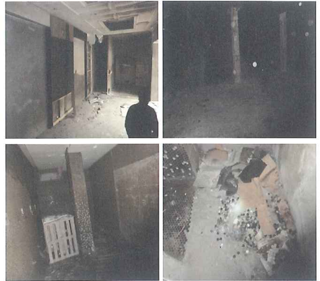
写真12 出火室の焼損状況
