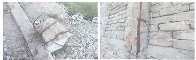
写真9 倒壊したビルの柱の鉄筋の状況
