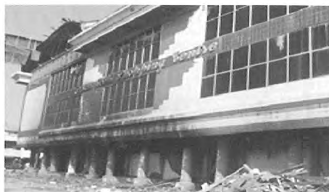
写真9 地震発生後の商業ビルの火災
