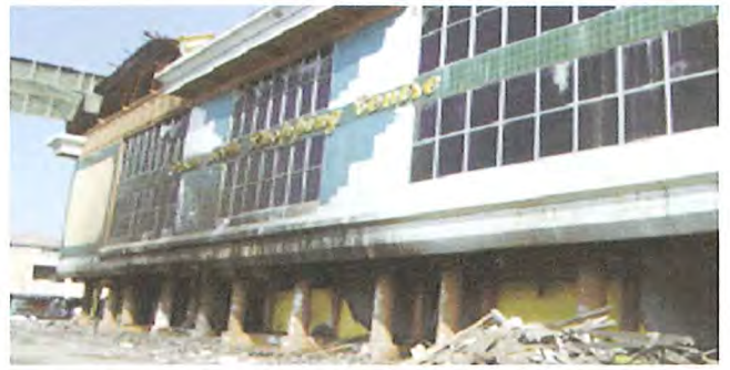
写真9 (前号から再掲) 地震発生後の商業ビルの火災
