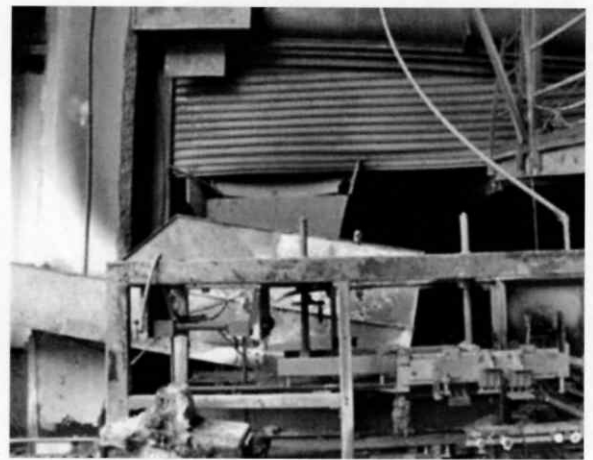
図4 端材室2階部分東側の防火シャッター
