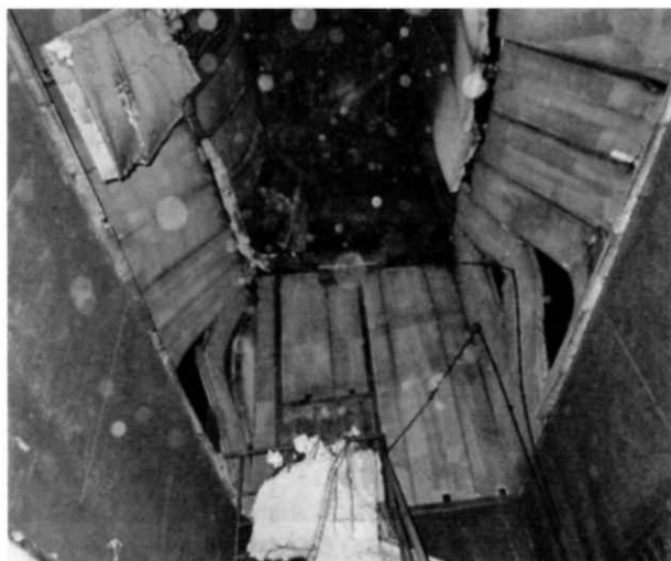
図6 階段室内 ALC パネル損傷状況 (検討会資料より)
