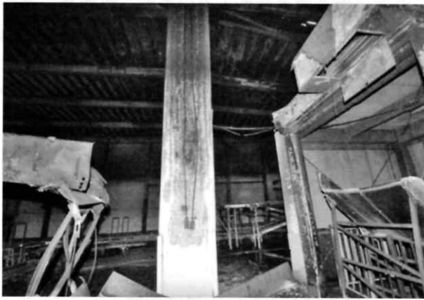
図3 端材室上部開口部（2階部分）付近の 爆裂している柱
