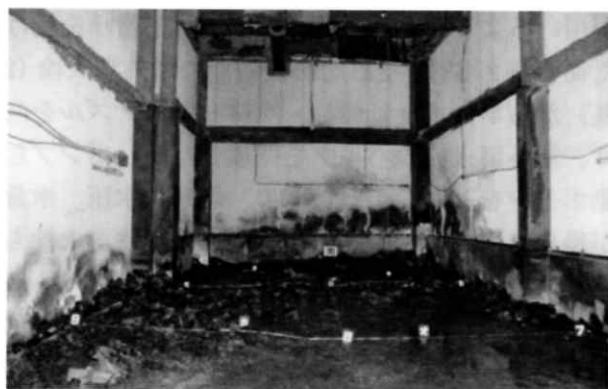
図1 端材室南側内部の状態 （写真右上の黒い箇所が2階への開口部） （検討会資料より）
