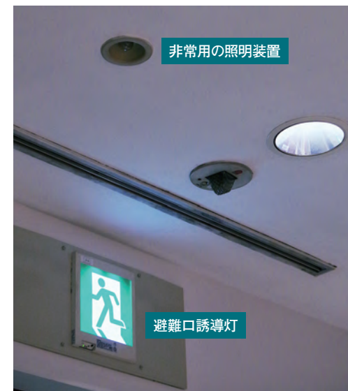
避難口誘導灯と非常用の照明装置
