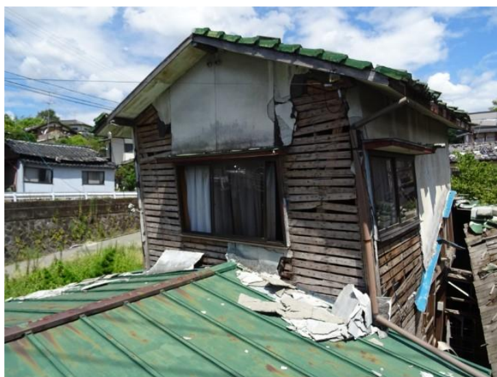
図2 熊本地震の際に剥がれ落ちた防火構造のモルタル被覆 熊本県益城町(筆者撮影)
