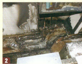
1 中華料理店の1年経過した防火ダンパー (出典：(公助)東京防災救急協会「飲食店の火災予防一厨房ダクト火災を防ぐ」) / 2 焼き肉店のダクト内の焼損状況 (出典：東京消防庁「令和5年度火災の実態」)
