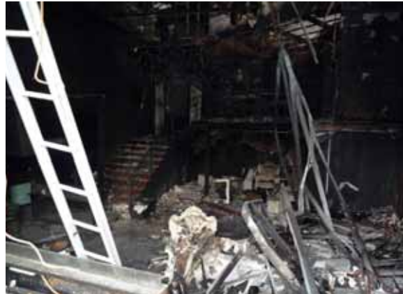
左記の窓からのVIPルーム内観 VIPルームにも2階席あり（左階段で上へ） 空間上部の損傷が激しく、例えば木製の階段の踏面は燃焼せず。天井裏から延焼した模様
