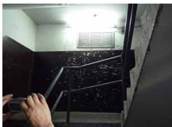
階段室内の加圧用の給気口（小さい）
