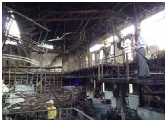
正面が北、右側が東（北面、東面にも2階席） 正面下のお椀型のフレーム（直径約10m）は天井装飾の落下物
