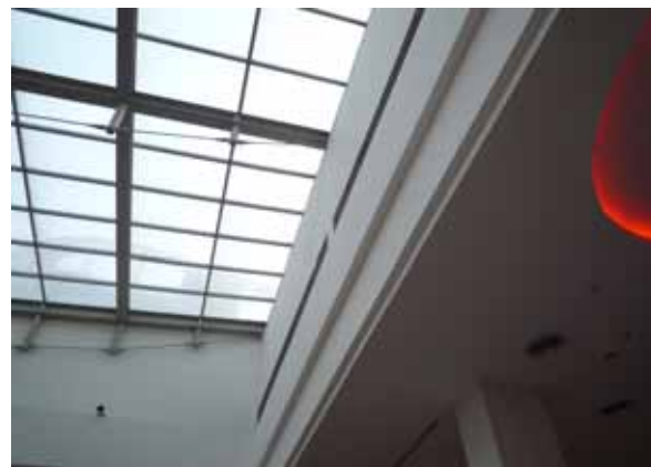
吹抜頂部で排煙義務 ( 機械排煙口スリット ) 機械排煙が一般的な計画のようである。 機械排煙では効かないはず。自然排煙の方が適切。大きなトップライトがあるのに。
