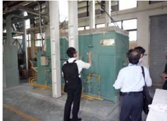
小型水平炉（炉内寸法は奥行 1m、幅 3m 程度）
