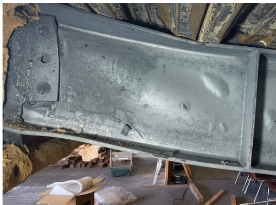
写真 1 2021 年度実験の無耐火被覆小梁端部の損傷状況
